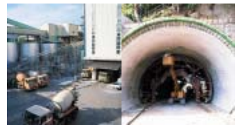
●HI-300/330およびHI-300J/330Jシリーズは、生コンプラントや施工現場で活躍します。
